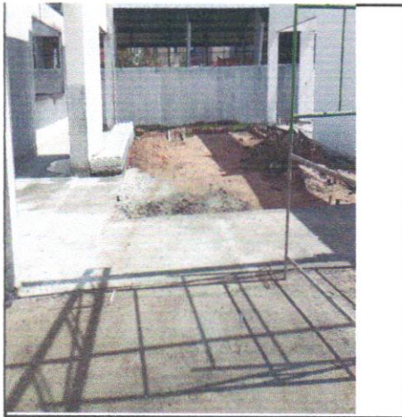
FOTO 39 - PISO CIMENTADO, TRAÇO 1:3 (CIMENTO E AREIA), ACABAMENTO LISO, ESPESSURA 2,0 CM, PREPARO MECÂNICO DA ARGAMASSA. AF_09/2020
