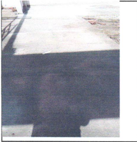
FOTO 37 - PISO CIMENTADO, TRAÇO 1:3 (CIMENTO E AREIA), ACABAMENTO LISO, ESPESSURA 2,0 CM, PREPARO MECÂNICO DA ARGAMASSA. AF_09/2020
