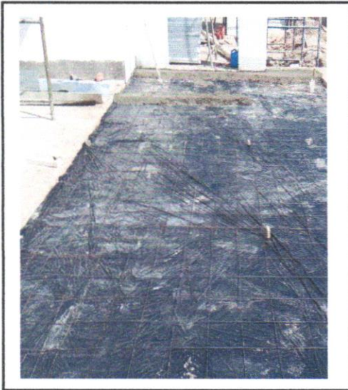
FOTO - 17 - PISO CIMENTADO, TRAÇO 1:3 (CIMENTO E AREIA), ACABAMENTO LISO, ESPESSURA 2,0 CM, PREPARO MECÂNICO DA ARGAMASSA. AF_09/2020
